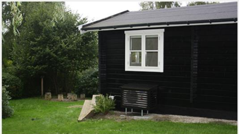
NÅR DEN DEKORATIVE SKJULER ER BLEVET MALET ER DET UMULIGT AT SE VARMEPUMPENS UDEDEL.
